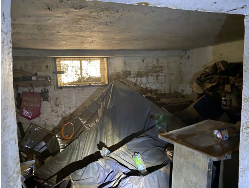
So sahen die Räume aus, als wir die Arbeit im riesigen Keller begannen. Es hat uns einiges an Zeit und Kraft gekostet die Zimmer leerräumen, doch dies war notwendig, da wir sonst nicht mit den Abpumparbeiten beginnen konnten.
